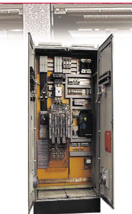
Vores styreskabe til elektriske forvarmere varierer fra 50 til 800 kW.
